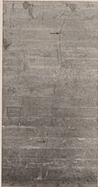
Abb. 11c. Spaltriß in einer Unterführung.
