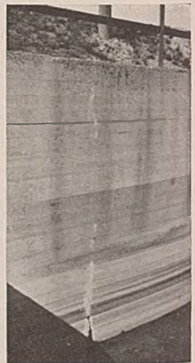
Abb. 13. Spaltriß in der Stirnwand und Decke eines Eisenbetondükers.
