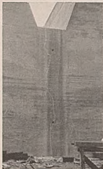
Abb. 8d. Schalenriß an der Querseite einer Schleusenmittelmauer.
