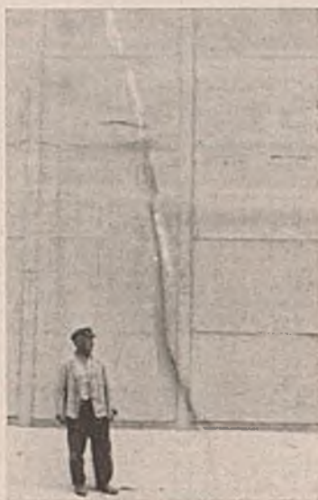
Abb. 8a. Schalenriß in einer Schleusenmauer.
