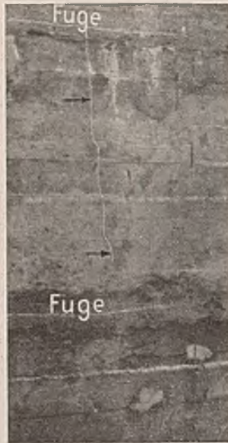
Abb. 11d. Spaltriß zwischen zwei Arbeitsfugen in einem Widerlager.
