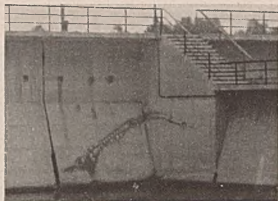
Abb. 8c. Schalenriß auf der Rückseite einer Schleusenmauer.
