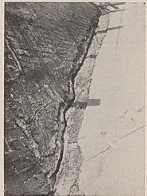
Abb. 11a. Rißverlauf auf der talwärts gerichteten linken Seite des Gewölbes genau in der Verschnidung mit den Flügeln. (Abdichtung und Schutzbeton sind entfernt.)
