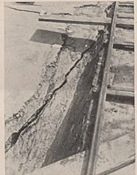
Abb. 11b. Rißverlauf am Gewölbescheitel und zur rechten Seite hin.
