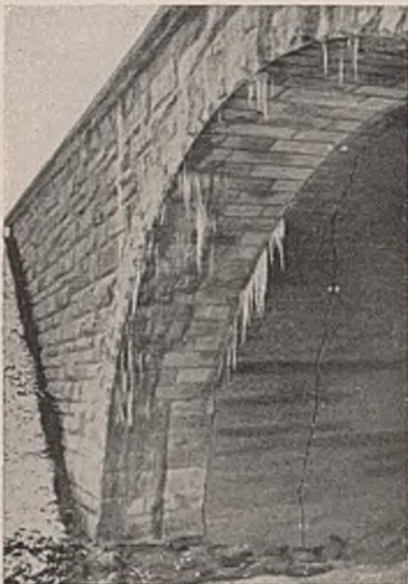
Abb. 17b. Blick ins Innere des Bauwerks. Der Rißverlauf des abgetrennten Flügels ist deutlich zu erkennen.
