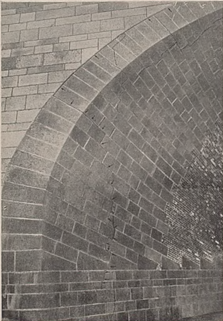
Abb. 23. Rißverlauf am beschädigten Gewölbeende.
