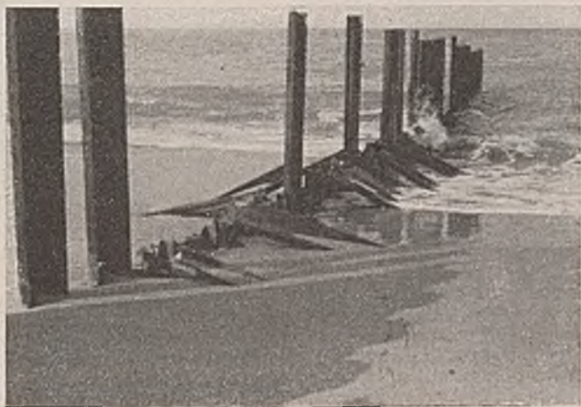
Abb. 20. Durch Sandschliff geschwächte und herausgeschlagene Stahlspundbohlen Größe I. Die umgeschlagenen Bohlen hängen an den Flanschen noch mit der Bohle zusammen.
