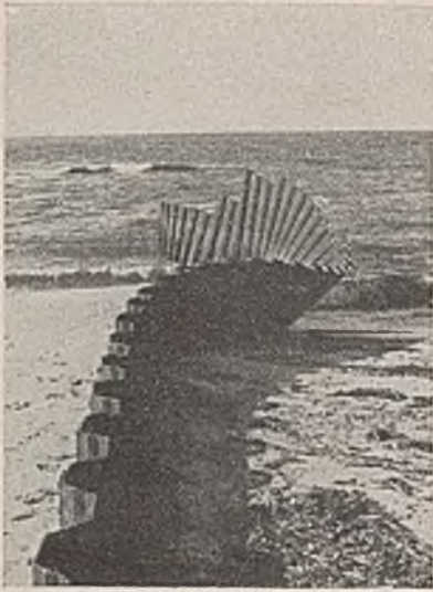
Abb. 6. Seitliches Ausweichen der Stahlpundbohlen bei Buhne 81.
