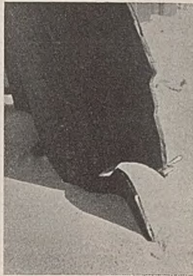
Abb. 8. Zerstörung an Buhne 75.
