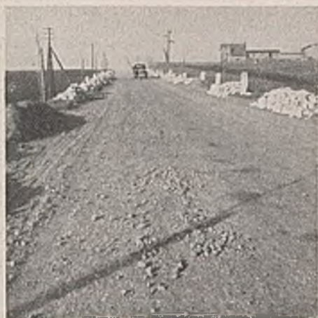
Abb. 1. Leichter Frostschaden auf einer Schotterdecke zeigt Verdrückungen und losen Schotter.
