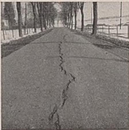
Abb. 5. Schwerere Frostschäden einer mittelschweren Decke. Die Strecke liegt auf 50 cm hohem Damm und hat auf beiden Seiten Straßengräben. Risse in der Fahrbahnmitte etwa 600 m lang. 28. Februar 1940.
