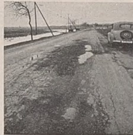
Abb. 6. Tauschäden auf einer Bitumen-decke, die unter dem Verkehr durchgebrochen ist. Rinnenspuren der Fahrzeuge sichtbar. In 100 m Entfernung dieselbe Schadensart. April 1940.
