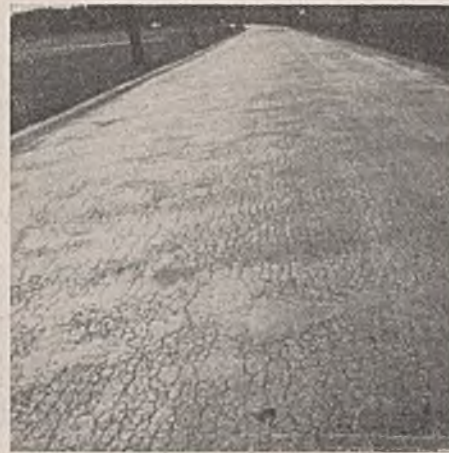
Abb. 3. Leichtere Frostschäden auf der Oberflächenbehandlung einer Dammstrecke. Durch Frosthebung entstandene Elefantenhaut.
