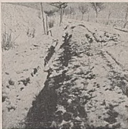
Abb. 2. Schwerer Frostschaden auf einer Schotterdecke — nach starkem und langem Frost sowie schnellem Auftauen — zeigt durchgebrochene Steinbahn.
