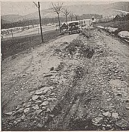
Abb. 7. Tauschaden in 1050 m Meereshöhe. Unter starkem Osterverkehr durchgebrochene Schotterdecke bei plötzlichem, kräftigem Tauwetter. Untergrund: Steinbahn, Glimmerschiefer. April 1939.
