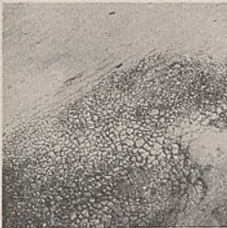
Abb. 11. Netzrisse in mittelschwerer Asphaltdecke.
