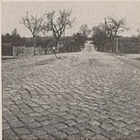
Abb. 15. Tauschaden April 1940. Verdrückung und Einbruch einer Kleinpflasterdecke mit 22 cm dickem Unterbau auf Schluffboden. Belderseits Gräben.
