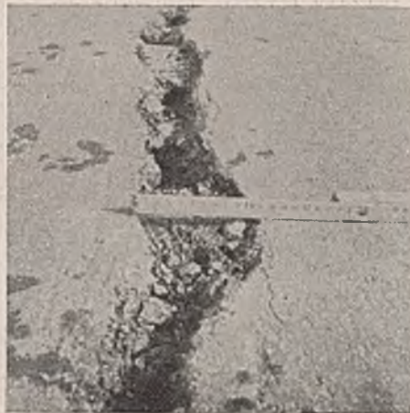
Abb. 12. 10 cm breiter Frosthebungsriß in der Mitte der Fahrbahn einer mittelschweren Decke. 22. Februar 1940.
