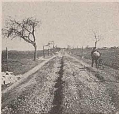
Abb. 14. Tauschaden. Bei plötzlichem Tauwetter zusammengebrochene Steinbahn mit Oberflächenverwitterung. Schwache Steinbahn über Schluffboden. Grundwasser im Frühjahr — 0,70 m.
