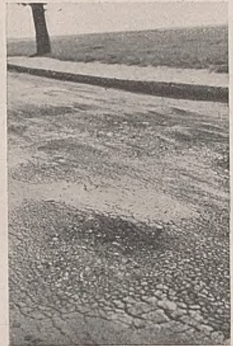
Abb. 13. Stark verdrückte Packlagedecke. Durch Frosthebung entstandene Netzrisse, durch Tauschäden stark verdrückte Fahrbahn. Ergebnis: die richtige Stuckerstrecke.
