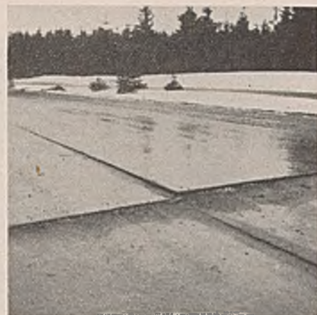
Abb. 16. Ungleichmäßige Randhebung einer Betonstraße. Rampenkelle aus bindigem Kies zur Fahrbarmachung der Strecke.
