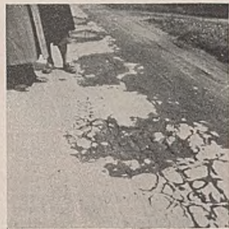
Abb. 19. Zerstörte 5 cm dicke Asphaltfeinbetondecke der Abb. 18.
