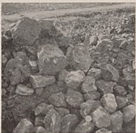
Abb. 17. Abgängige Packlage, zwecks Erneuerung aufgebrochen. Sandstein mit tonigem und kalkigem Bindemittel, großenteils zu Schottergröße (5 bis 10 cm) verwittert. Einzelne größere Packlagesteine von 12 cm können leicht zerschlagen werden.
