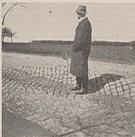
Abb. 20. Verdrücktes und eingebrochenes Kleinpflaster auf 20 cm guter Packlage und 10 cm Schotterlage auf 0,60 bis 1,00 m hohem Damm aus Schluffboden.
