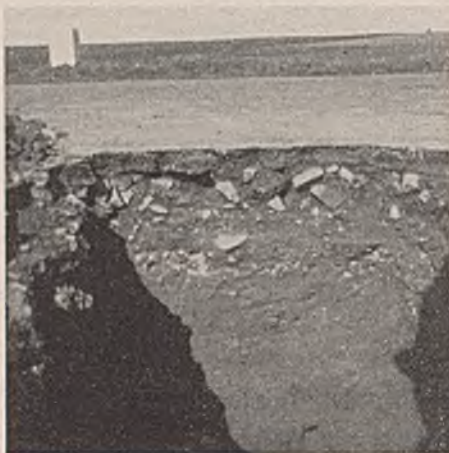
Abb. 18. Zu schwache Steinbahn und schlecht gesetzte Packlage, durchdrungen vom Schluff des Untergrundes. Darüber 5 cm Asphaltfeinbetondecke. Trotz 1,00 bis 1,30 m hoher Dammstrecke und beiderseitiger Gräben durch Frostschäden zerstört, wie Abb. 19 zeigt.
