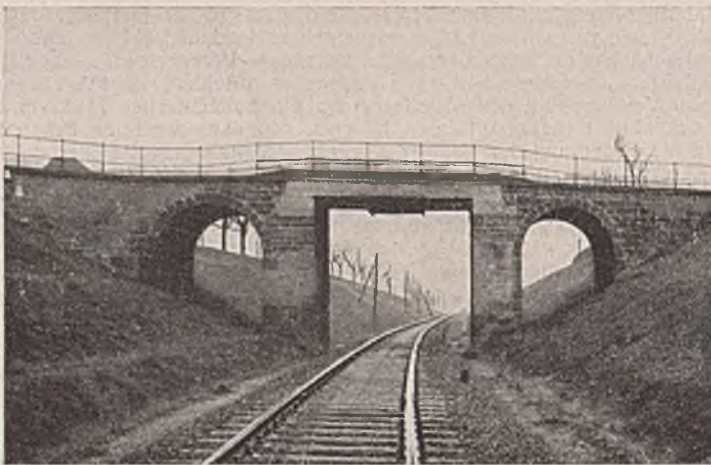
Abb. 14. Ein böses Gegenbeispiel. Vor dem Umbau hat das Bauwerk zwar anspruchslos, aber sicher noch befriedigend ausgesehen. Der Einbau der ebenen Decke hat ein häßliches Gebilde erzeugt. Besonders stören der Sprung im Gesimsband, die kurze Anrampung auf der Fahrbahn und der unklare Übergang zwischen Beton und Mauerwerk.
