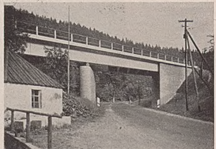
Abb. 17. Das Unterführungsbauwerk ist gut gestaltet und sauber ausgeführt. Unbefriedigend ist die schräg zur Pfeilerachse stehende große Auflagerrolle. Zu empfehlen wäre eine Versenkung bis zu einer gewissen Tiefe oder die Anwendung eines Kugellagers mit rundem Grundriß.
