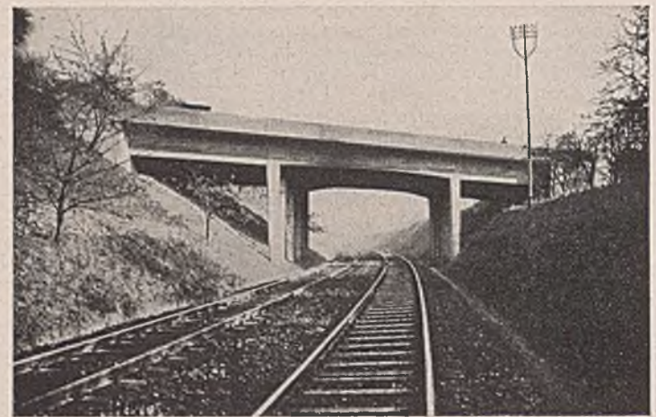
Abb. 15. Die Massivbrüstung macht den Überbau im Vergleich zu den sehr schlanken Stützen viel zu schwer. Der Stich in der inneren Leibung der Mittelöffnung ist zu stark. Die Sichtflächen sehen wenig befriedigend aus.
