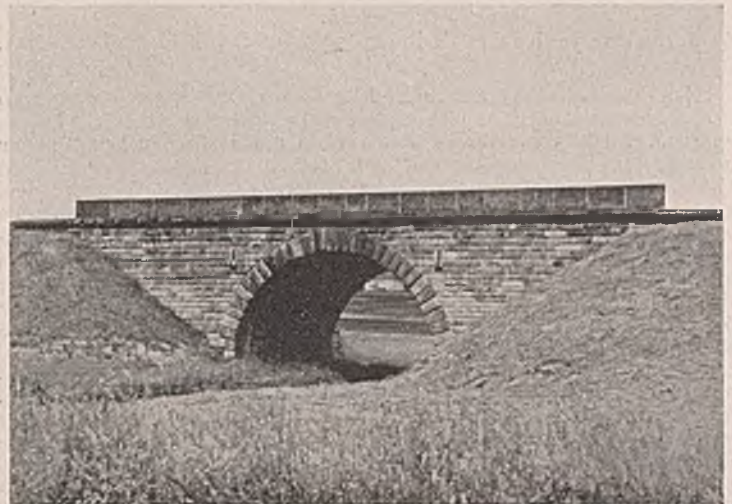
Abb. 2. Daß das Bauwerk eine alte Eisenbahnbrücke ist, sieht man ihm nicht auf den ersten Blick an. Es ist so gut gestaltet, daß es sich auch heute durchaus sehen lassen kann.
