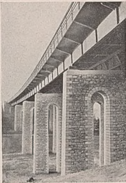
Abb. 50. Die gekrümmte Talbrücke ist sehr befriedigend gestaltet. Etwas stören die unter dem ausgekragten Fußweg sichtbaren Wasserrohre. Die Verblendsteine sind teilweise etwas winzlig, was bei heller Verfügung weniger auffallen würde.
