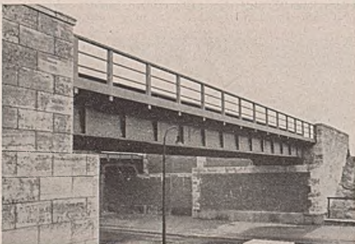
Abb. 37. Das Unterführungsbauwerk ist gut gelungen. Nur stört etwas das Sichtbarwerden des Fußwegbelages am Geländer.
