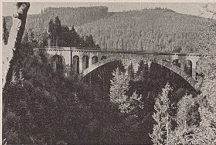
Abb. 7. Über der tiefen, waldigen Schlucht wölbt sich der kühn geschwungene Brückenbogen aus Granit. Infolge der kapellenartigen Auflösung wirkt er verhältnismäßig leicht.
