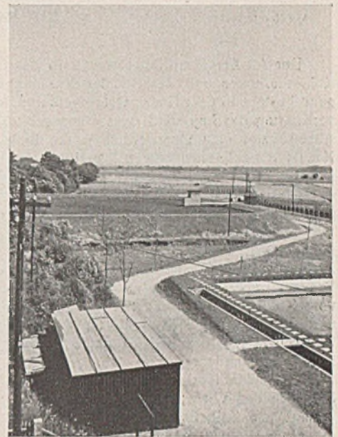
Abb. 11. Faulbecken mit Entnahmeschacht. Dahinter die Trockenbeete. Vorn die Absetzbecken.
