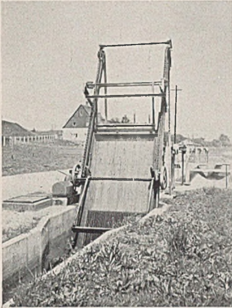
Abb. 2. Passavant-Greiferrechen, dahinter der Sandfang.
