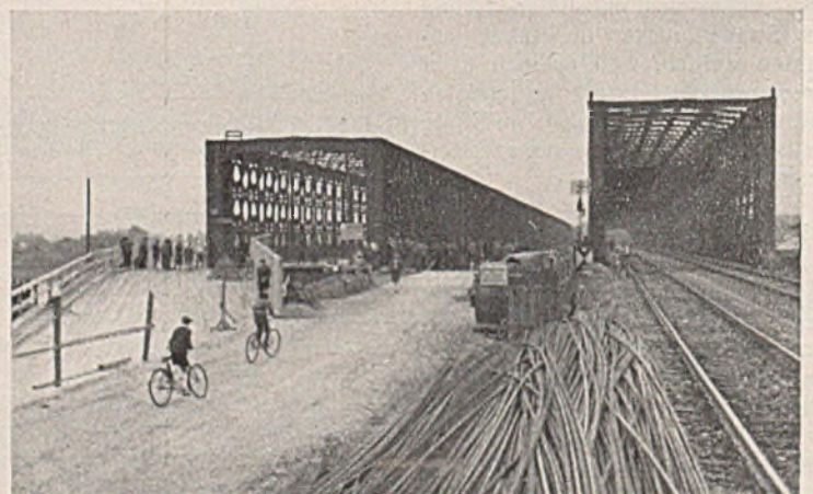
Abb. 5. Ansicht der Straßenbrücke vom linken Ufer während der Verschiebung. Aufgenommen am 16. August 1938.
