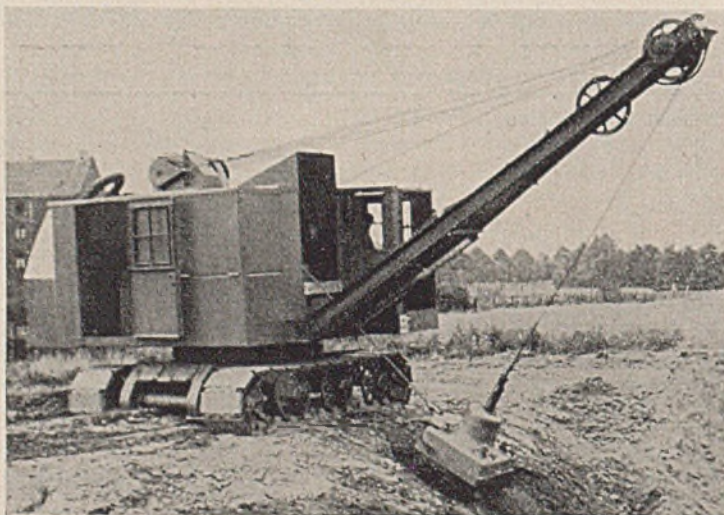
Abb. 2. Stampfbagger der Demag beim Verdichten einer Böschung. Das Stampfgewicht wird durch ein zweites Seil senkrecht zur Böschung geführt.
