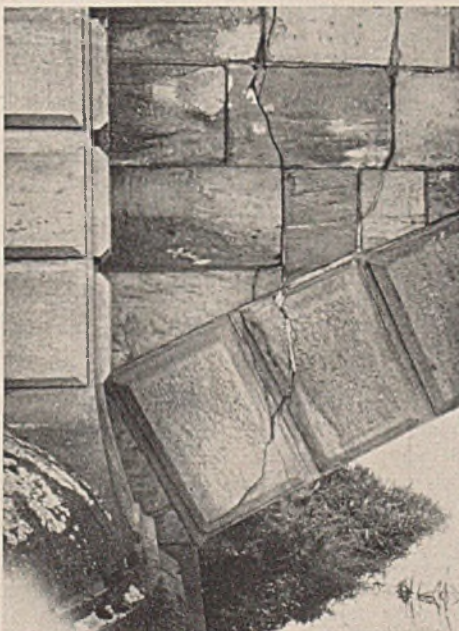
Abb. 2. Risse in der alten Flutbrücke.
