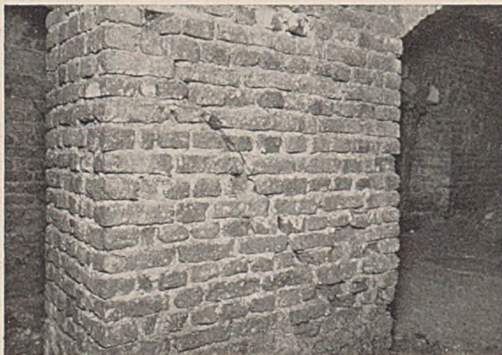
Abb. 5. Innenpfeiler aus Ziegelmauerwerk mit Riß.
