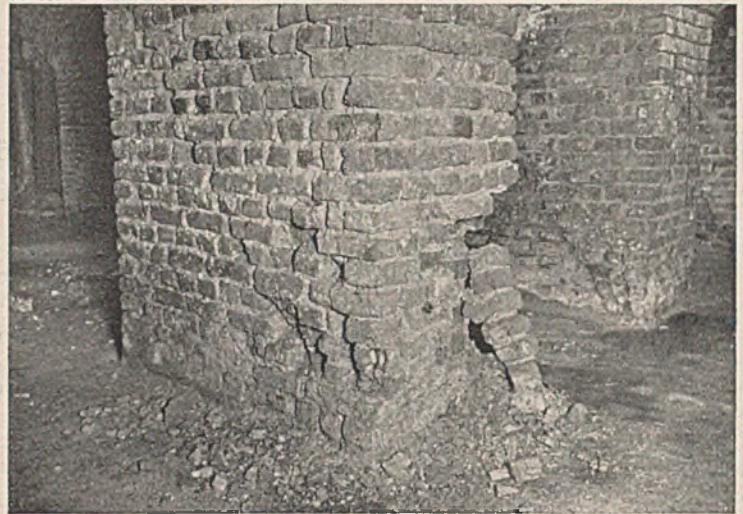
Abb. 6. Innenpfeiler aus Ziegelmauerwerk erheblich beschädigt.
