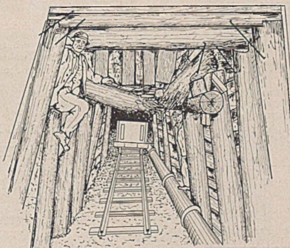
Abb. 3. Firstbruch im Richtungsstollen bei km 8,325.
