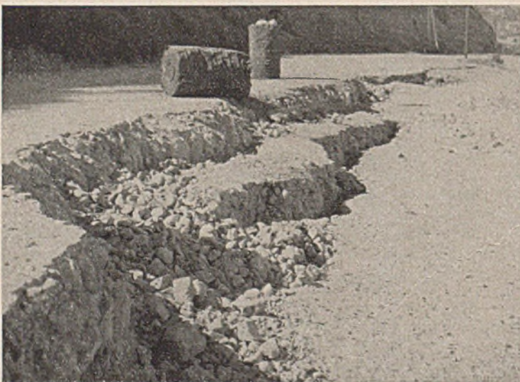
Abb. 28. Setzungen in der Straße nach Mostaganem infolge unterirdischer Ausspülung.
