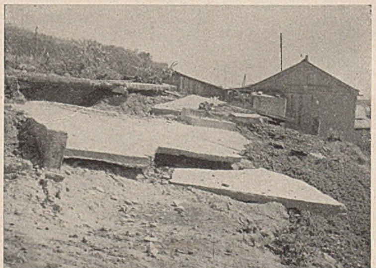
Abb. 29. Abgesunkene Fußbodenplatte einer Badehütte bei Mostaganem.
