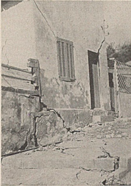
Abb. 30. Schäden an einem Wohnhaus bei Mostaganem kurz vor seinem Einsturz.
