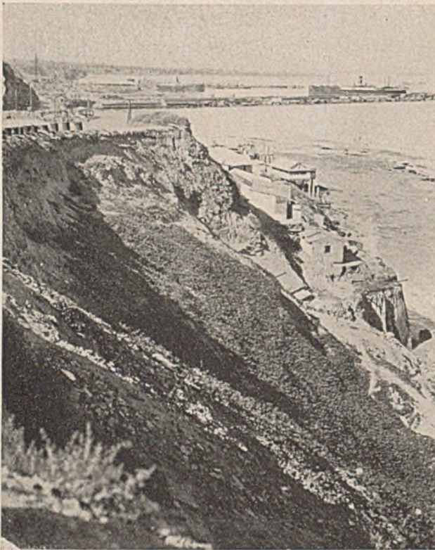
Abb. 26. Ausspülungsstelle an der Landstraße nach Mostaganem mit Blick auf den Hafen.
