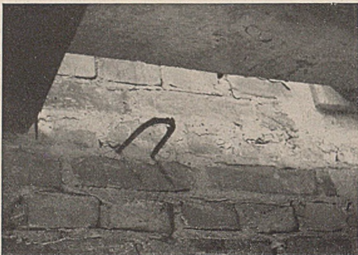
Abb. 17. Eingemauerter eiserner Bügel zur Befestigung der Verankerungen der Gerüste.
