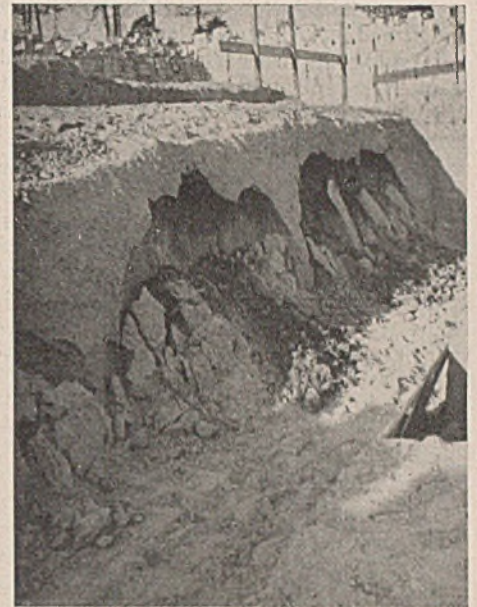
Abb. 4. Zu steil angelegte Böschungen rutschen oft nach.
