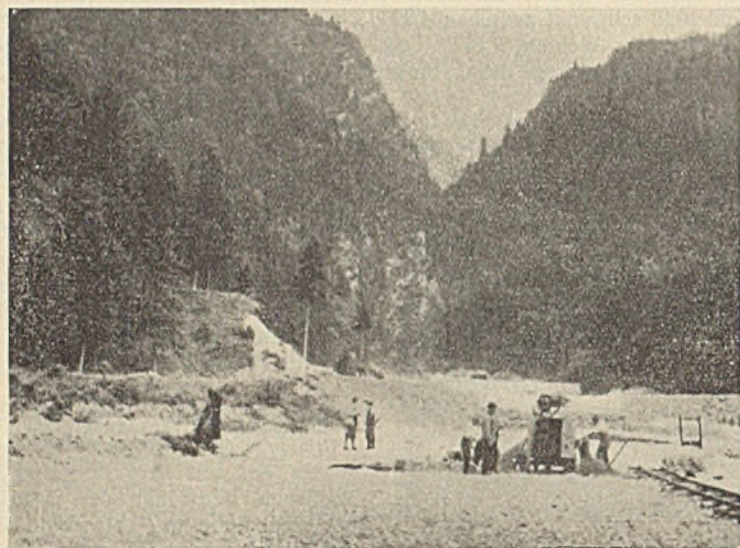
Abb. 78. Uriaine. Erhöhung der zweiten Rückhaltesperre.
