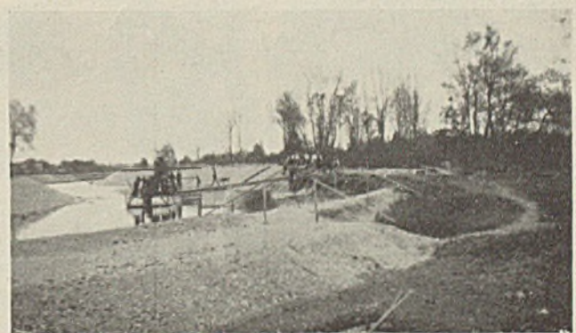
Abb. 51. Amper zwischen Wehr Olching und Mündung des Triebwerkkanals bei Geiselbullach. Wiederherstellung eines geregelten Flußlaufes im Kleinbaggerbetrieb.
