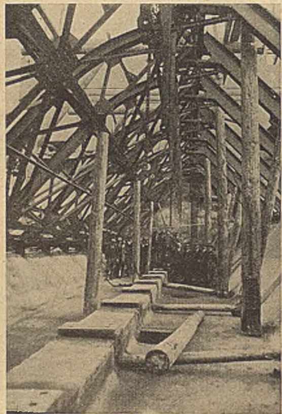
Abb. 18. Dachwehrkonstruktion Hallein der Kellner-Partington Paper Pulp Co. Limd. in Montage. (Ausführung J. Pflöschinger & Komp.)
