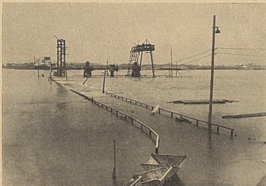
Abb. 19. Rheinbrücke Düsseldorf—Neuß. Bild der durch Hochwasser vollständig überschwemmten Baustelle.
