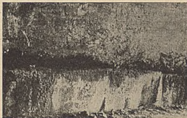
Abb. 18. Zerstörung in einer Arbeitsfuge bei Verwendung von zu trockenem Beton.
