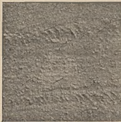
Abb. 3. Oberfläche einer Platte, die auf trockenem Untergrund liegt. Keinerlei Nachbehandlung. Zahlreiche örtliche Schwindrisse zufolge der raschen Austrocknung des Betons im jungen Alter.
