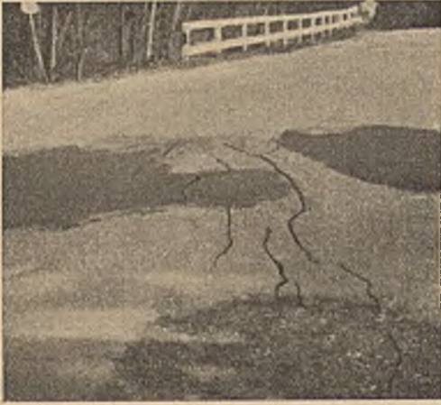
Abb. 1. Frosterscheinungen an der Oberfläche einer Macadamstraße infolge Undichtigkeit einer darunterliegenden Wasserrohrleitung.
