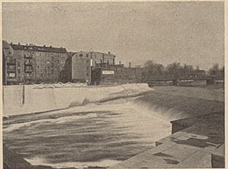
Abb. 9. Regulierung des rechten Ufers vor der Brücke mit dem Pfeiler für das neue Wehr.
