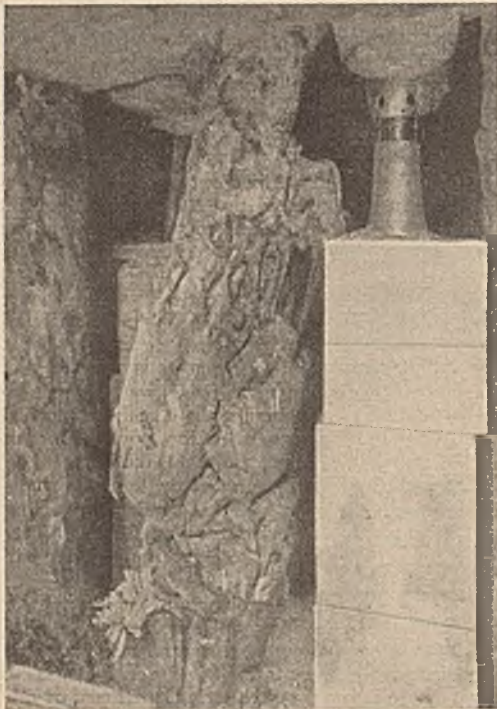
Abb. 1. Gestauchter Pfahl der ursprünglichen Gründung.
