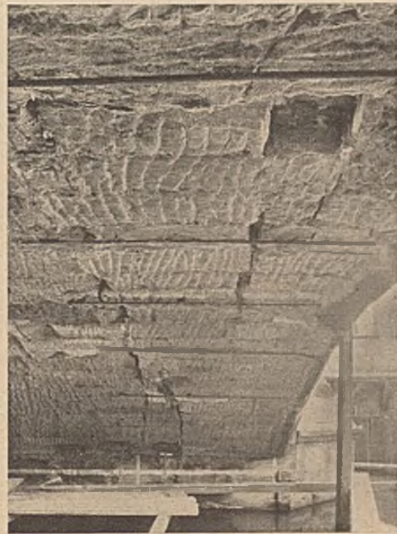
Abb. 5. Risse in der Gewölbeleitung.
