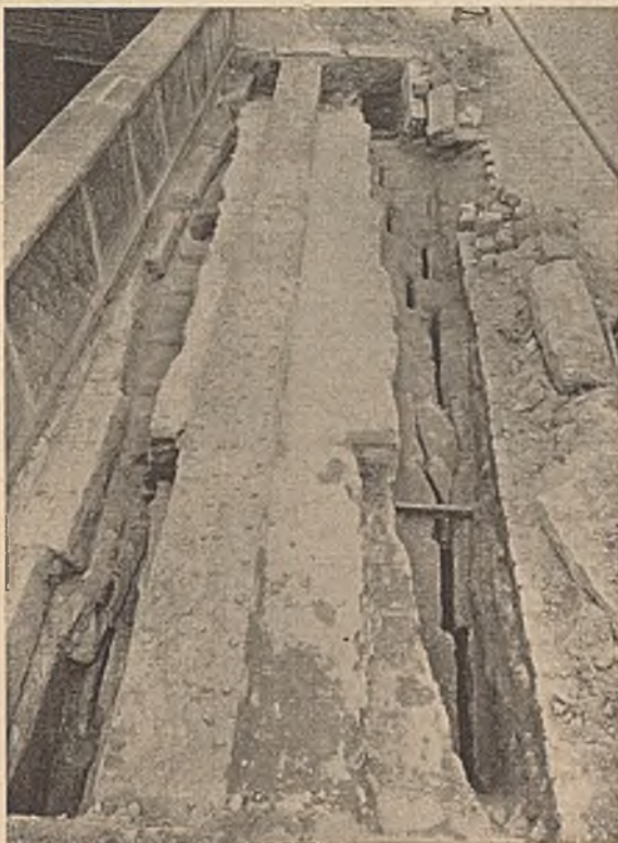
Abb. 4. Risse im Gewölberücken.
