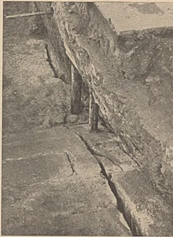
Abb. 3. Risse im Gewölberücken.
