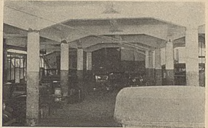
Abb. 4. Gebäude der Buick-Agentur: Blick in die Reparaturwerkstatt im Erdgeschoß. Die Putzabsprengungen rings um die Säulenköpfe an den Voutenansatzstellen sind deutlich wahrzunehmen.
