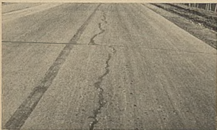
Abb. 1a. Rißbildung infolge fehlender Längsfugen.
