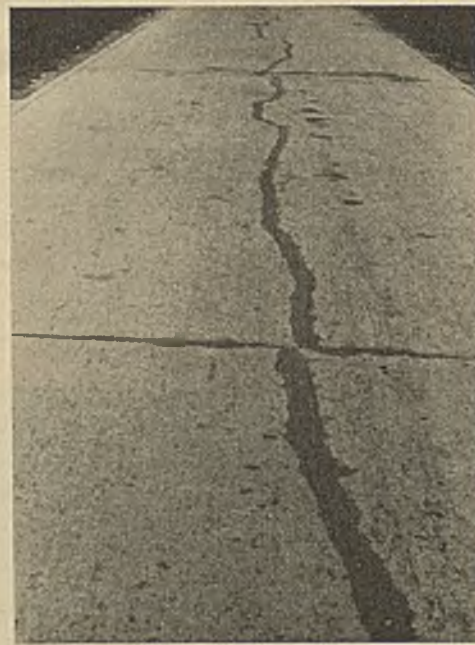
Abb. 10. Typische Längsrißbildung auf der Straße Kattowitz—Sorau zufolge schlechter Entwässerung des Straßenkörpers.
