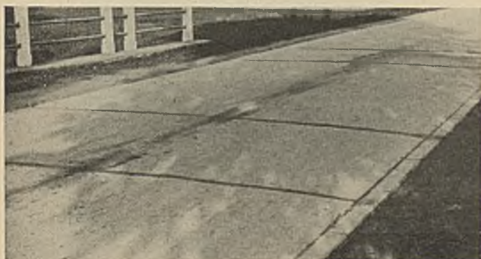
Abb. 7. Querrissbildung über einer Eisenbetonbalkenbrücke. Am Ende der Fahrbahntafel wurden Quersfugen angeordnet, die Querrisse stellten sich an der Hinterkante der Brückenwiderlager ein, da sich der ganze Kunstbau gegenüber dem Straßenkörper gesenkt hat. 1 = Längsriß, 2 = Querriß, 3 und 4 = Quersfugen, 5 = Querriß.
