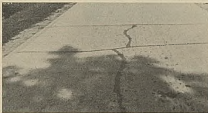
Abb. 8. Primärer Querriß, sekundäre Längsrisse auf der Straße Kattowitz—Sorau.
