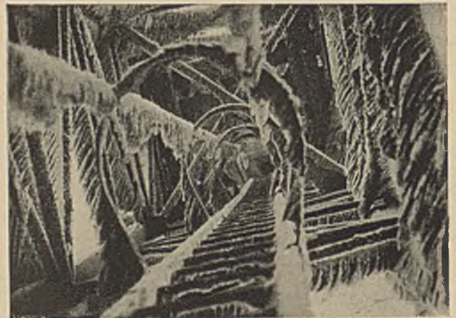
Abb. 3. Innenansicht des Mastes mit vereister Steigleiter.
