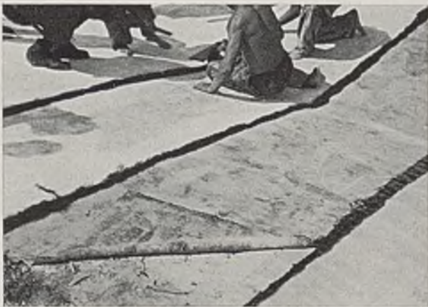
Abb. 12. Falsches Verkleben der Bitumengewebebahnen.
