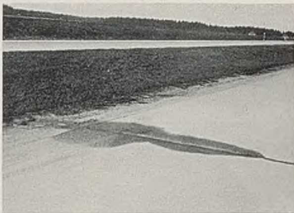
Abb. 16. Sicker-(Schmelz-)Wasser fließt aus einer Querrugung heraus.
