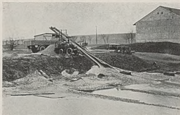
Abb. 2. Entladestelle eines leichten Schrappers von Schmidt, Kranz & Co. AG.
