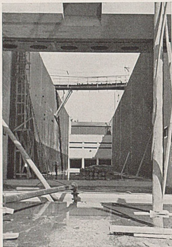
Abb. 24. Blick in die südliche Kammer der Schleusenanlage Stauwerder bei km 31 des Adolf Hitler-Kanals.
