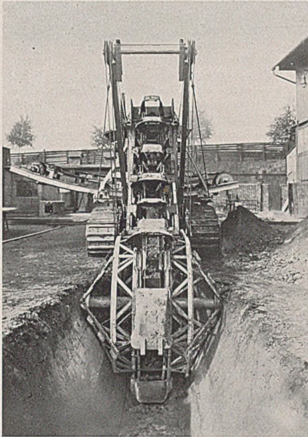
Abb. 2. Vorderansicht der Eimerleiter mit Böschungsschneider beim Eimerketten-Grabenbagger, Bauart Lübecker Maschinenbau-Gesellschaft, Type R. II. G.
