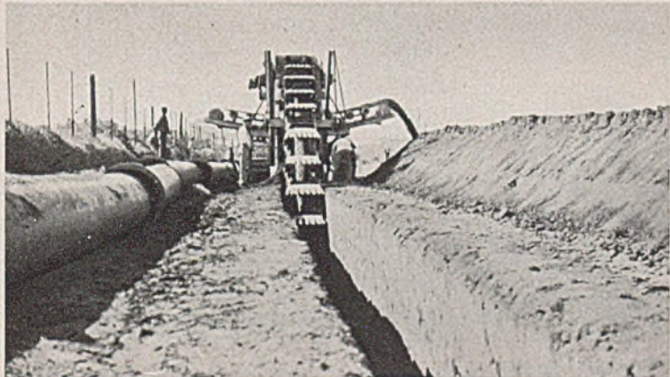
Abb. 3: Aushub eines Grabens mit senkrechten Wänden und seitliche Ablagerung des Baggerguts durch einen Eimerketten-Grabenbagger, Bauart Lübecker Maschinenbau-Gesellschaft, Type R. II. G., mit durchschiebbaren Bandförderer.
