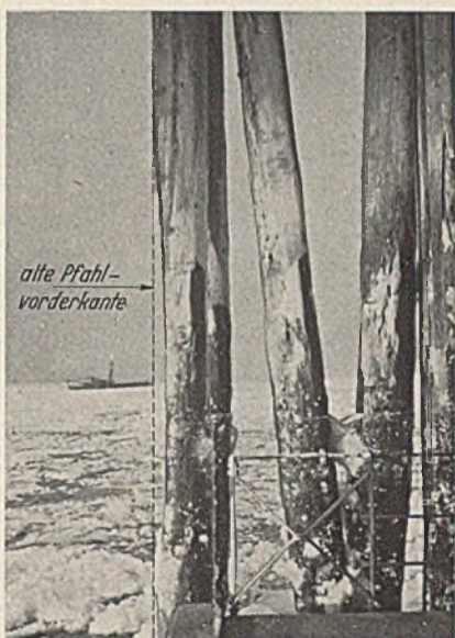
Abb. 15. Mech. Abnutzung ungeschützter Schutzdalben an Landungsanlagen durch Wallschienen.
