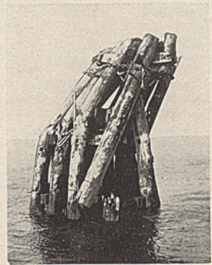
Abb. 32. Durch hochliegenden Stoß zerstörter angefauter Dalben.
