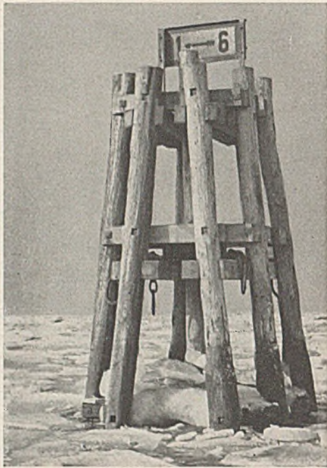
Abb. 37. Dalben nach Abschälen des faulen Splintholzes.
