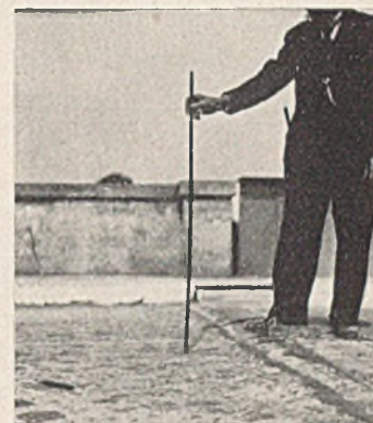
Abb. 16. Pflasterversackung hinter einem Widerlager ohne Gitterplatte.
