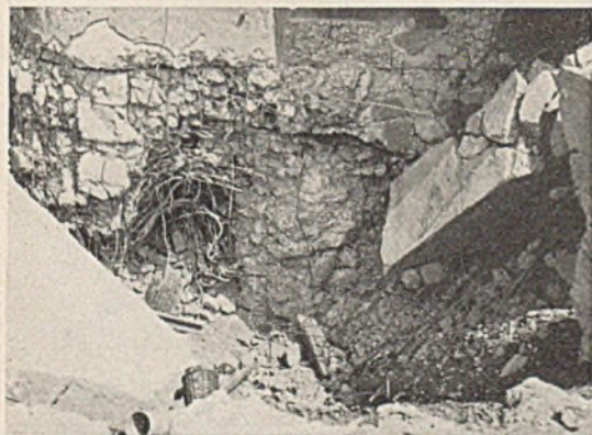
d) Zerstörung der Stahlbetonwand von außen frontal gesehen.
