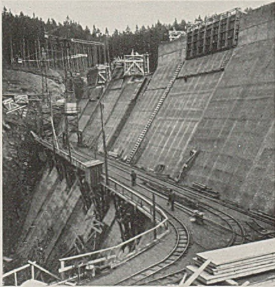
Abb. 6. Betonierbrücke an der Luftseite der Sperrmauer mit 2 Turmdrehkränen kurz vor Beendigung der Arbeiten.
