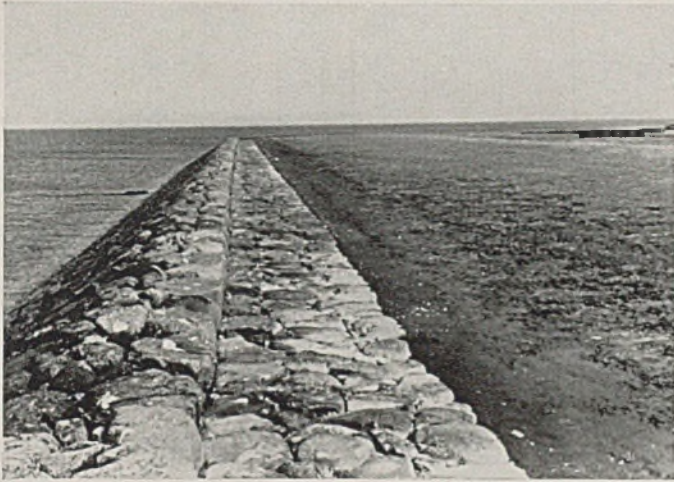
Abb. 9. Steindecke als Küstenschutz mit Hinterpflasterung. Der anschließende Grassoden ist zerstört.
