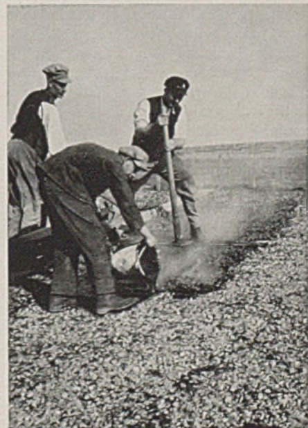
Abb. 6. Die obere Lage der Asphaltteigußdecke wird hergestellt durch Aufgießen von Asphaltmasse, Abdecken mit Splitt und Stampfen.
