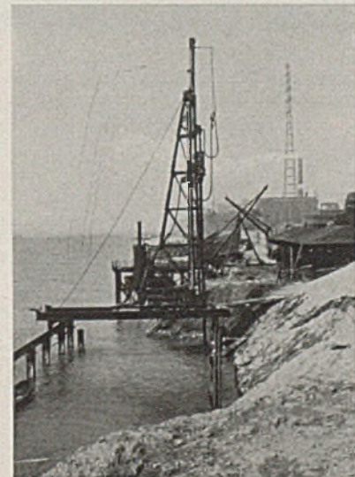
Abb. 9. Rammen der 17 m langen Spundbohlen von einem Rammgerüst. An der etwa 50 m weiter stromab sichtbaren Verladebrücke können Seedampfer anlegen.
