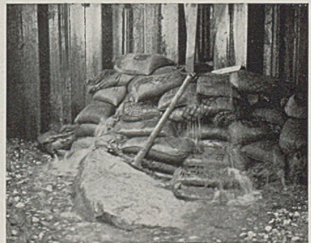
Abb. 21. Durchrammter Findling und dadurch verursachte Schloßsprengung. Eine schnell vorgebaute Sandsackpackung soll das Herausspülen des Bodens verhindern.
