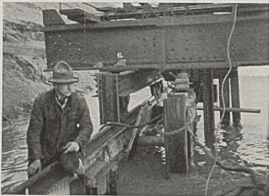
Abb. 10. Kranbahnträger bis zu halber Höhe vom Hochwasser überflutet. Rammwagen durch Flüssigkeitspressen auf bereits gerammten Spundbohlen abgefangen.
