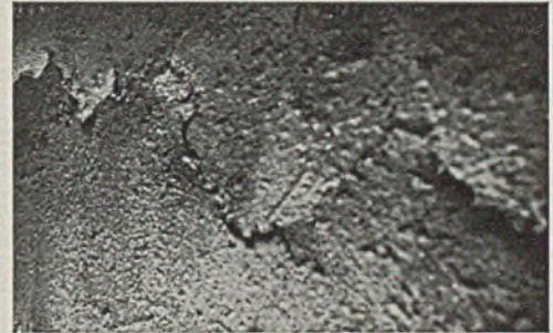
Abb. 6. Putz, der eine Wand-Dämmfuge überdeckte und beim elastischen Nachgeben derselben gestaucht wurde.
