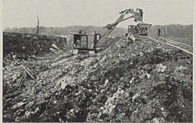
Abb. 4. Tertiär-Einschnitt südlich Kassel: Sandige Tone, stark wasserführend und wenig standfest.
