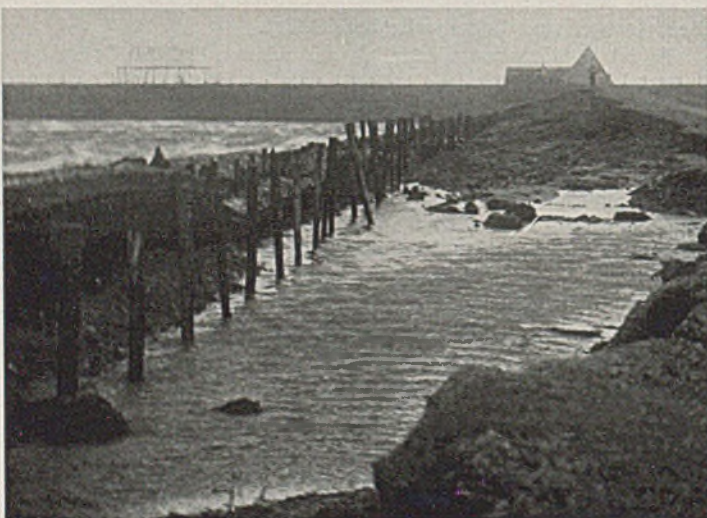
Abb. 3. Abbrüche oberhalb der Asphalteingußdecke; Beginn der Unterspülung von oben her.
