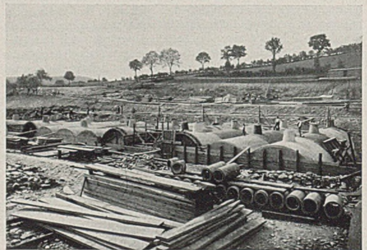
Abb. 8. Bau der „langsamen Sandfilter“ an der Talsperre der Stadt Chemnitz bei Einsiedel. Dorthin gelangt auch das Wasser aus den anderen drei Talsperren der Stadt.
