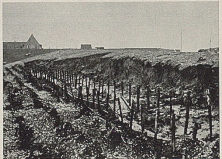
Abb. 5. Der obere Teil der Asphaltdecke ist auf die durch die Unterspülung freigelegten Pfähle aufgespießt.
