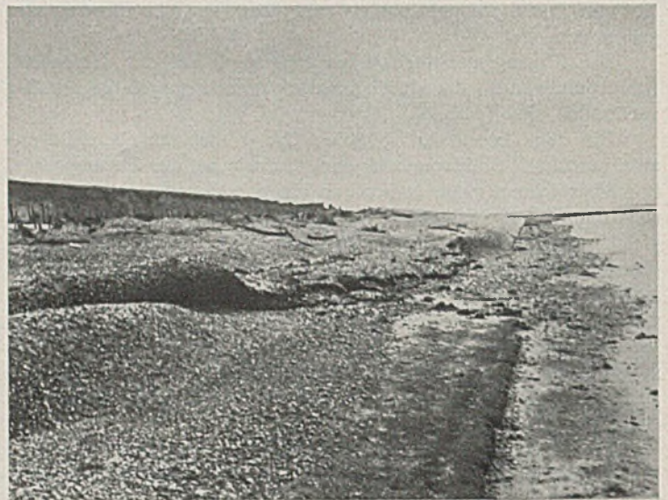
Abb. 4. Ausbeulungen des Asphaltbelages am Böschungsfuß.
