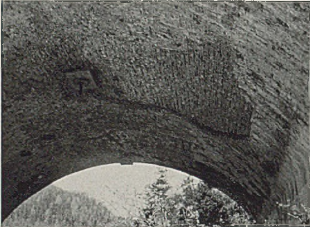
Abb. 3. Die angemauerte Innenschale fällt in zusammenhängenden Stücken herunter.
