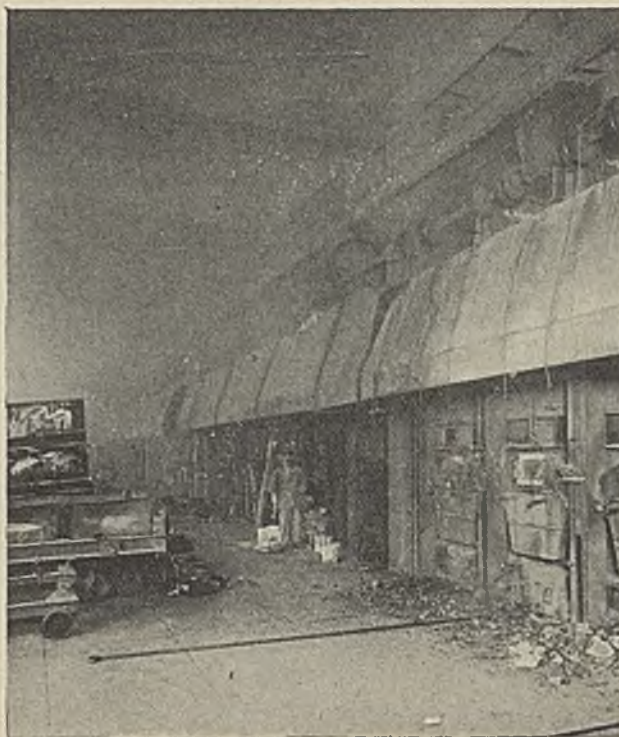
FIG. 7. — ASPECT DE LA CHAUFFERIE D'UNE USINE D'INCINÉRATION.
