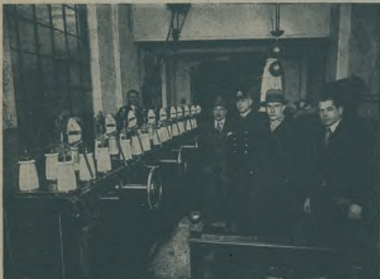
Odbiór wyłączników olejowych 20 kV dla Zakładu Elektrycznego Marynarki Wojennej w Gdyni, we własnej stacji prób o napięciu 150 kV.
