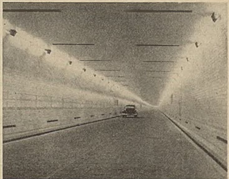
Abb. 9. Beleuchtung des Brooklyn-Battery-Tunnels
