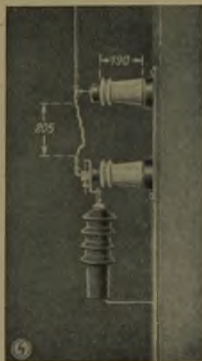
Rys. 10. Wyładowanie przy odgromniku katodowym (SSW).
