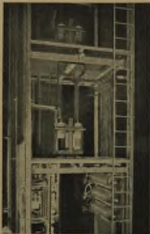
Rys. 4. Instalacja jednofazowych transformatorów syst. Bor- doni w b. Teatrze Artystów w Warszawie.
