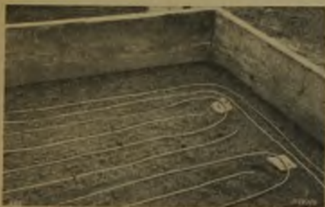
Rys. 1. Kabel do ogrzewania ziemi.
